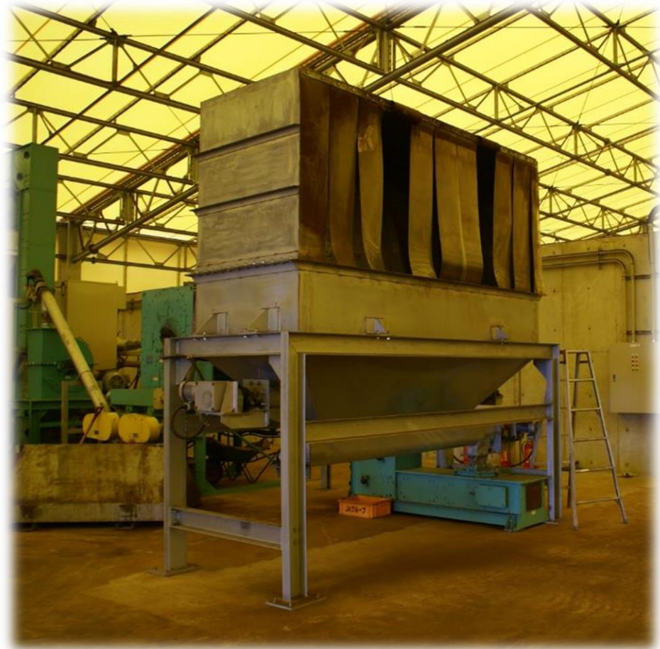
原料の投入槽
