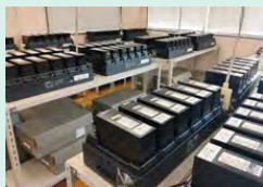
バッテリー保管・充電施設
