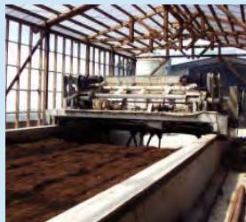
メタンの排出抑制、 良質な堆肥生産に資する 堆肥化処理施設
