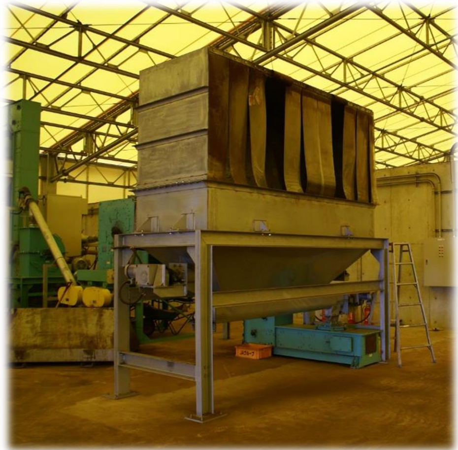
原料の投入槽
